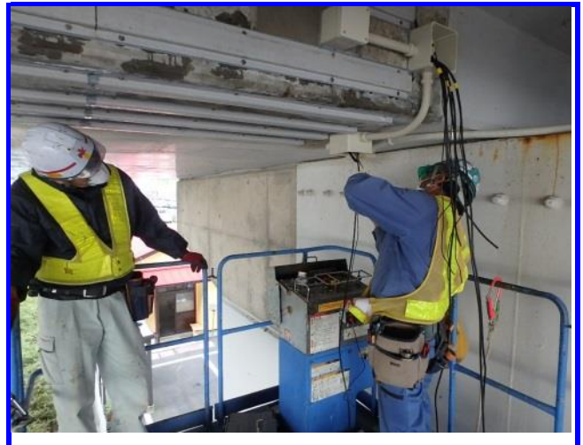
モニタリング用配線配管
