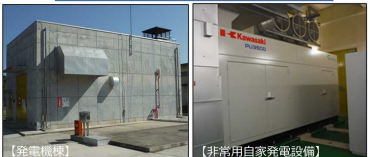
<鹿島浄水場 非常用自家発電設備>
