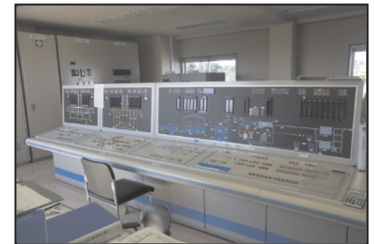
【中央監視制御設備の更新】
