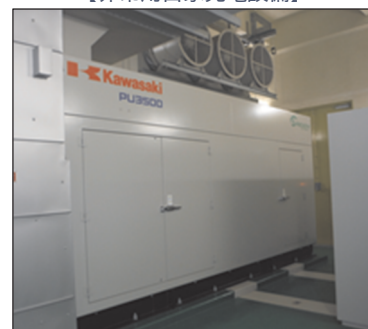
【非常用自家発電設備】
