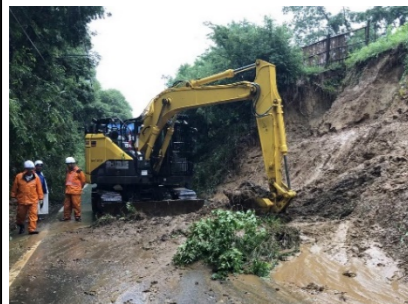
令和5年6月 梅雨前線等による豪雨 (法面崩壊箇所の応急復旧)
