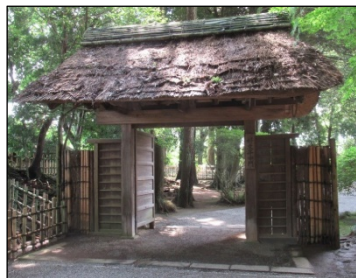
中門の劣化状況（屋根の劣化）
