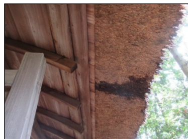
軒先の茅葺劣化状況
