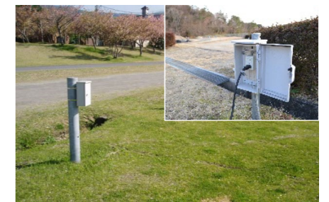
写真3：電源設備（イメージ）
