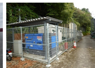
▲写真-7 非常用発電装置 （道の駅奥久慈だいが）
