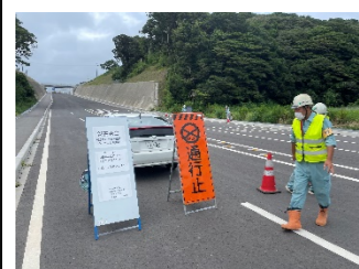
写真1 パトロール・緊急措置 (建設業協会等)
