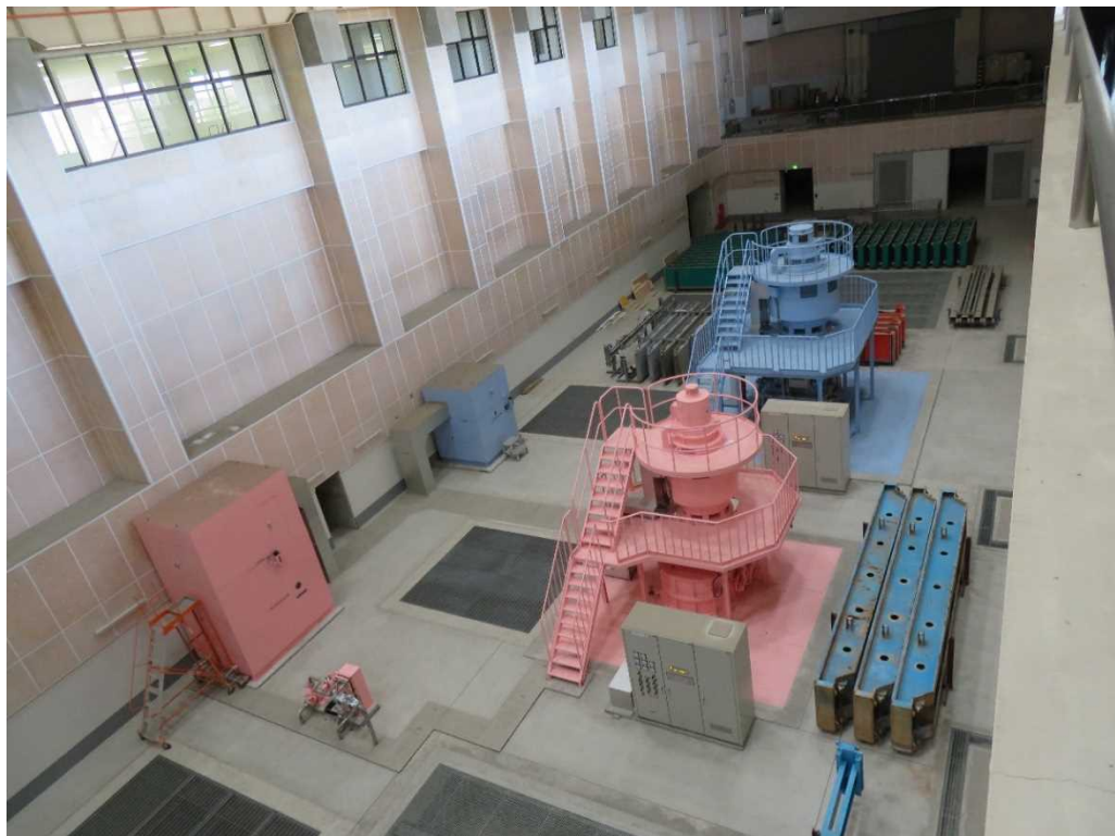
導水用ポンプ(主原動機)
