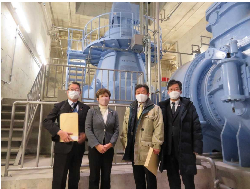
導水用ポンプ(主ポンプ)
