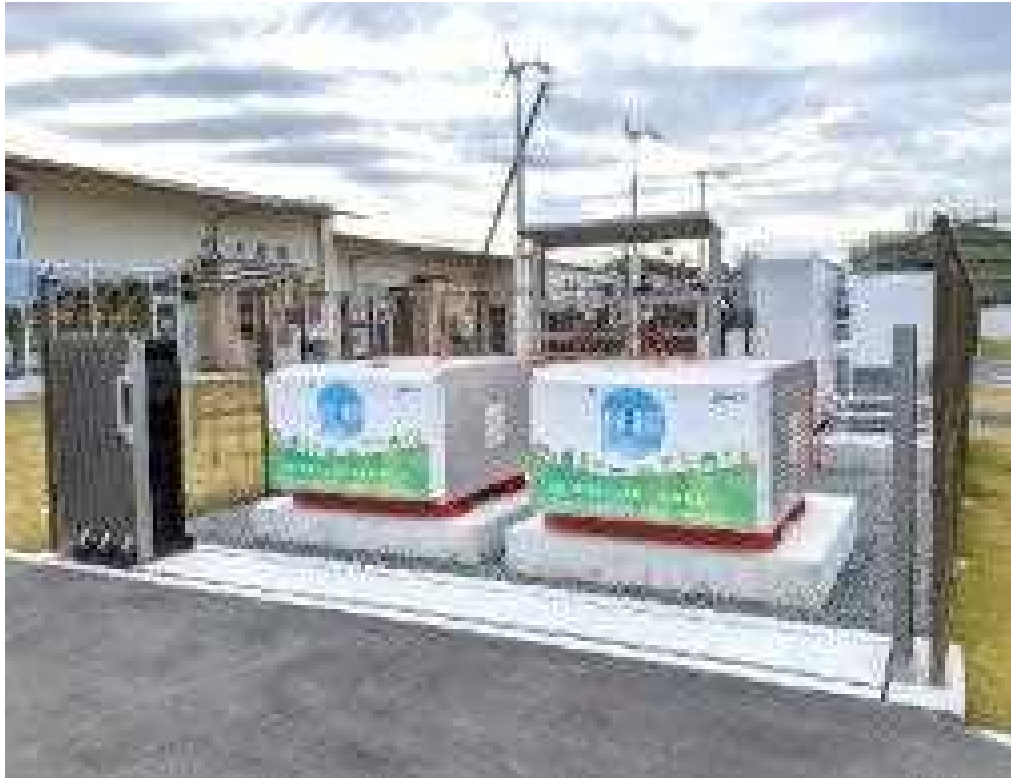
道の駅なみえ 純水素燃料電池外観(提供:浪江町)
