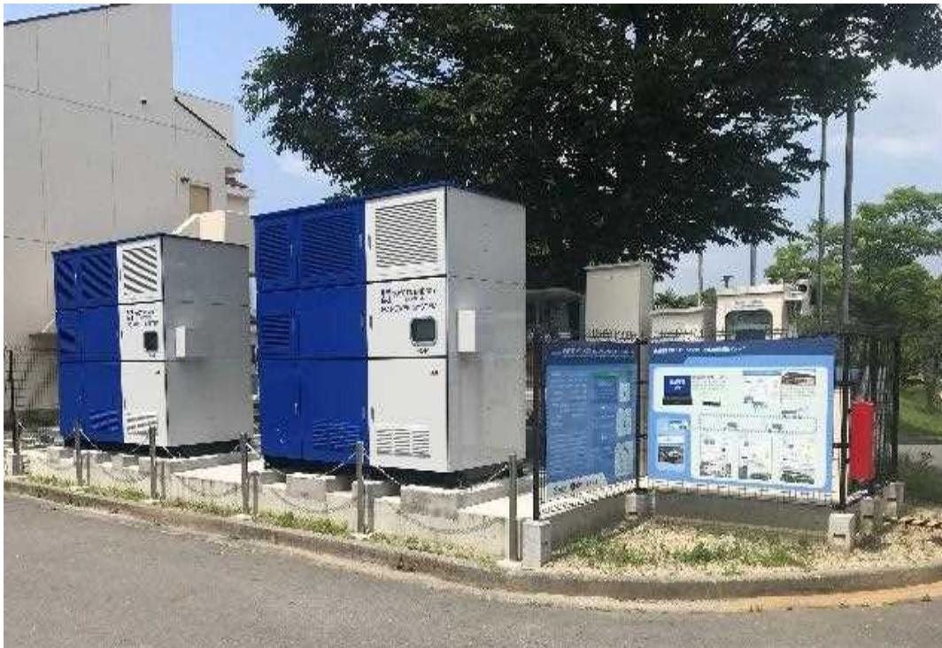
純水素燃料電池 外観(提供:浪江町)
