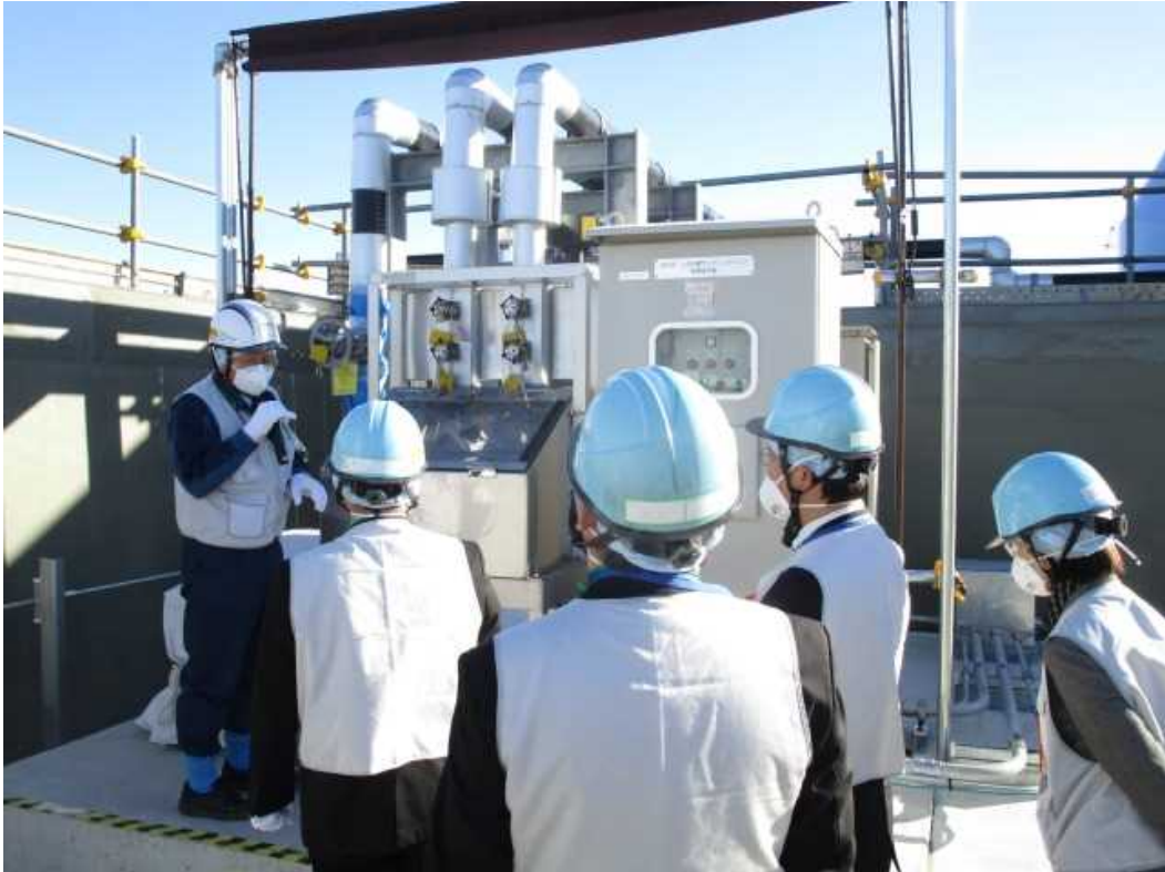
福島第一原子力発電所 放出管・上流水槽サンプリングラック現場操作盤
