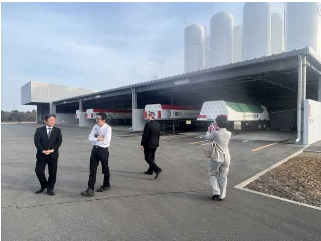
水素貯蔵・供給設備 外観
