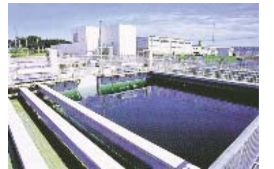
工業用水事業の水処理施設(沈でん池)
