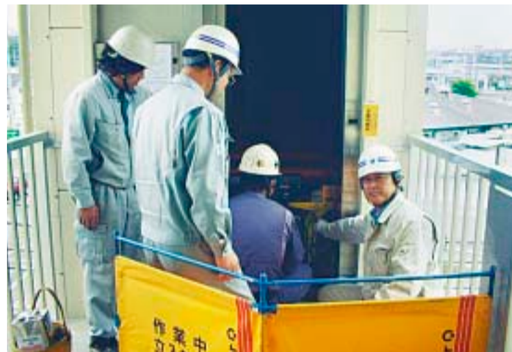
日立市内の県営住宅におけるエレベーター点検
