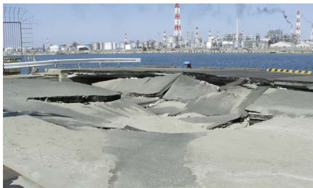
被災した鹿島港
