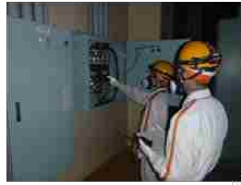
③ 電源切替盤(想定)
