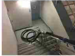
② 蒸気供給ホース敷設経路
