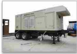
① 移動式発電機(既設同等)
