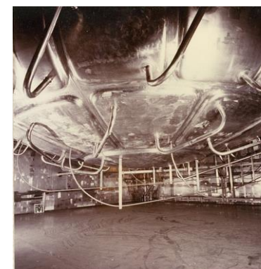
高放射性廃液貯槽(V34) 下部
