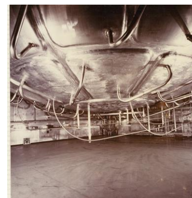
高放射性廃液貯槽 (V35) 下部
