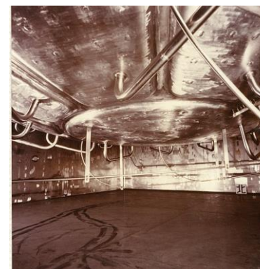
高放射性廃液貯槽 (V32) 下部
