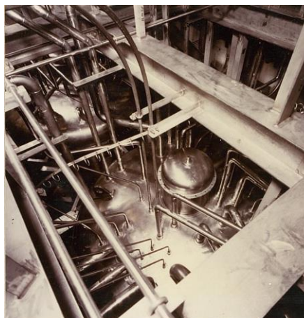
中間貯槽 (V37)
