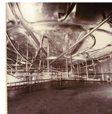
高放射性廃液貯槽(V36) 下部
