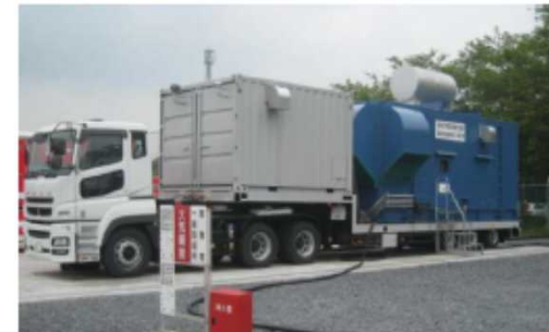
常設代替高圧電源装置
