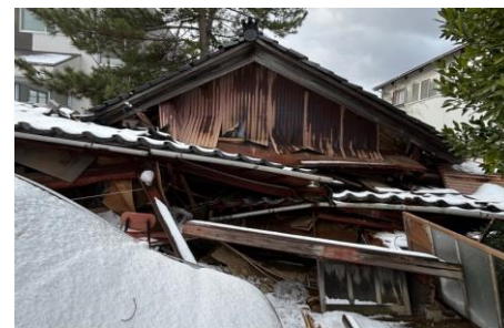
地震による木造住宅の被害
