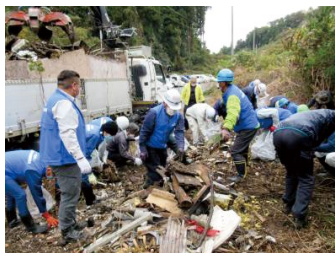
▲不法投棄現場でのボランティア撤去
