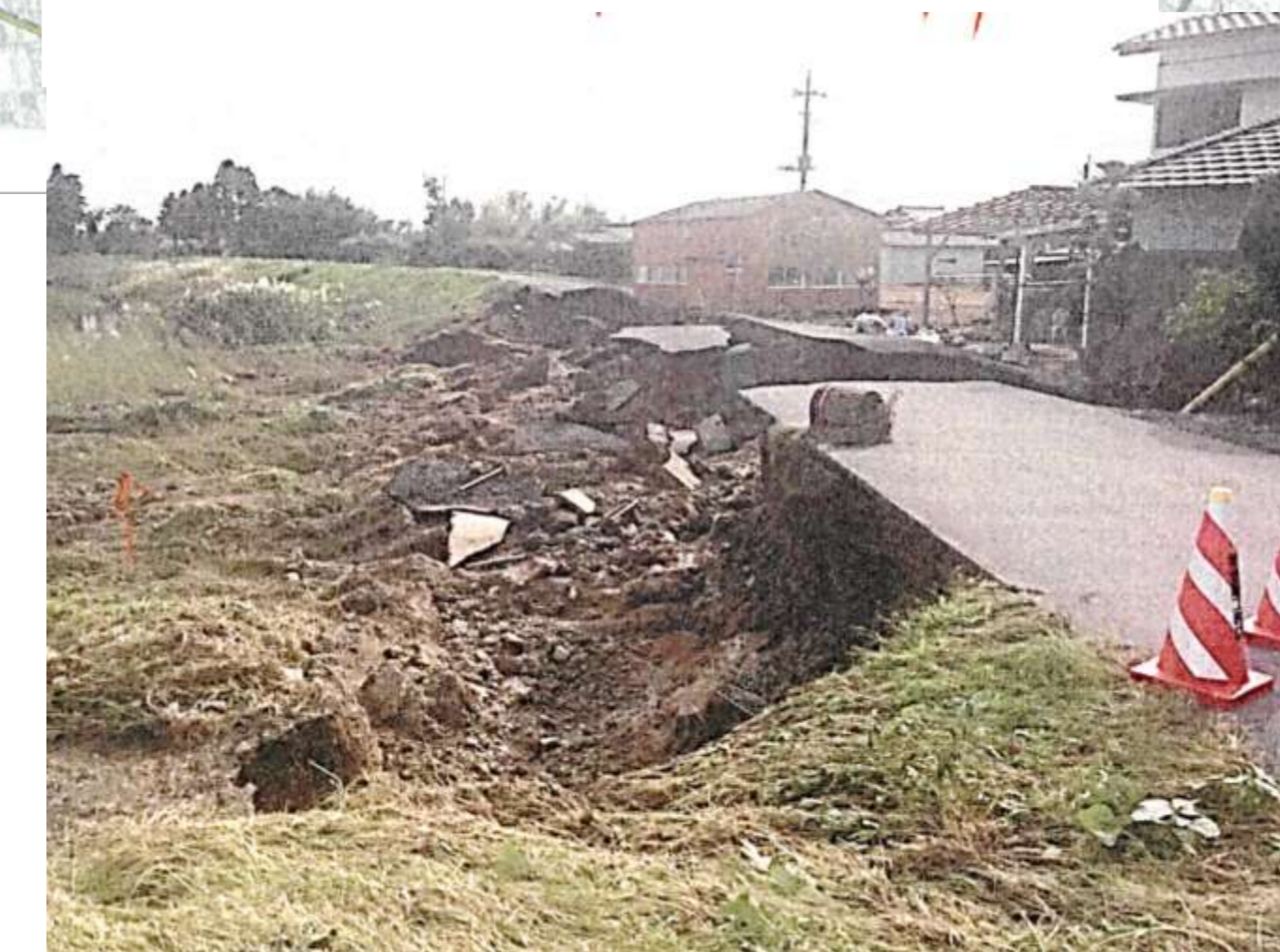
○浅川(常陸太田市松栄町)堤防決壊 【被災直後】 (権限代行)
