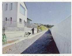
写真-4 新築家屋の棚に残された浸水痕跡
