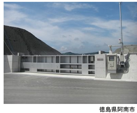
水門・陸閘門の自動化・遠隔操作化
