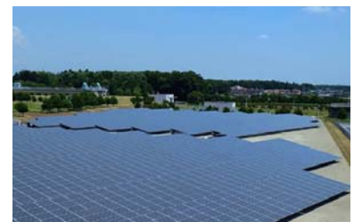
災害時も機能が維持できる ライフライン(県中央水道事務所)
