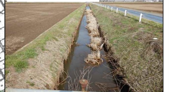
排水路(経年劣化)
