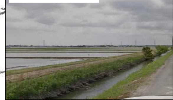
導水路(経年劣化)
