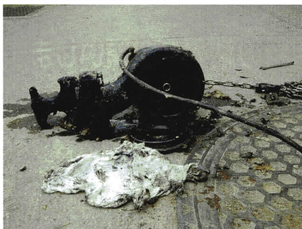
汚水ポンプに絡まったタオル
