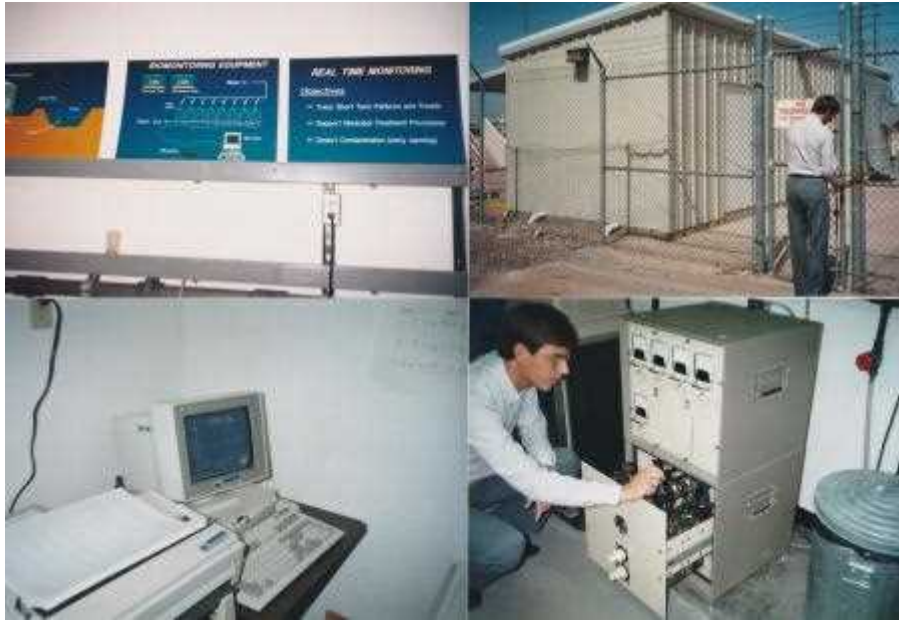
SRPのバイオモニタリング施設の設置状況
