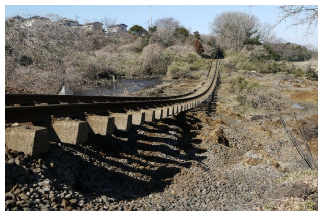
路盤の流出によって宙に浮いた線路（ひたちなか市）
