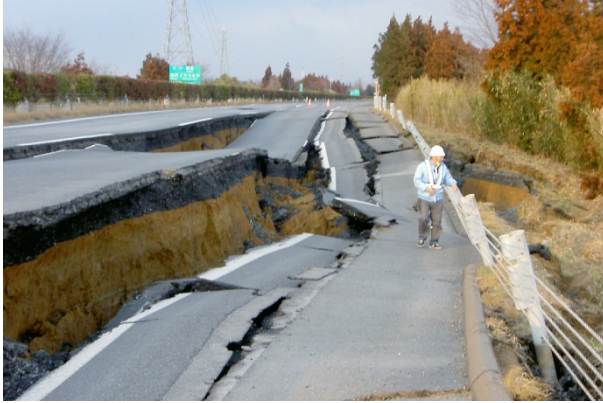
路面が陥没した常磐自動車道（水戸～那珂）
