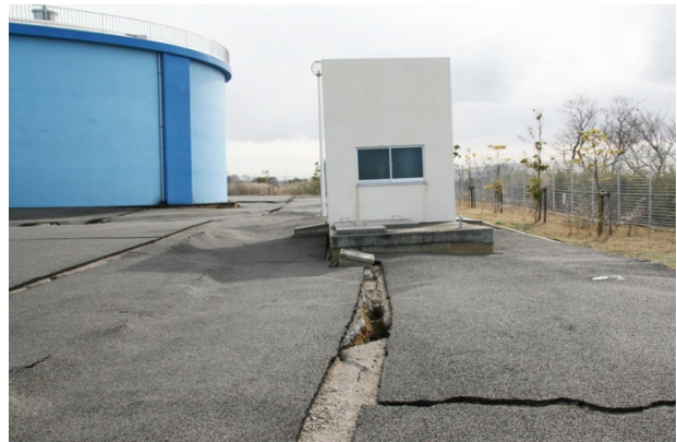
被災した配水施設（神栖市）
