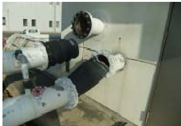
配水管が損傷した那珂久慈ブロック広域汚泥処理施設 （ひたちなか市）
