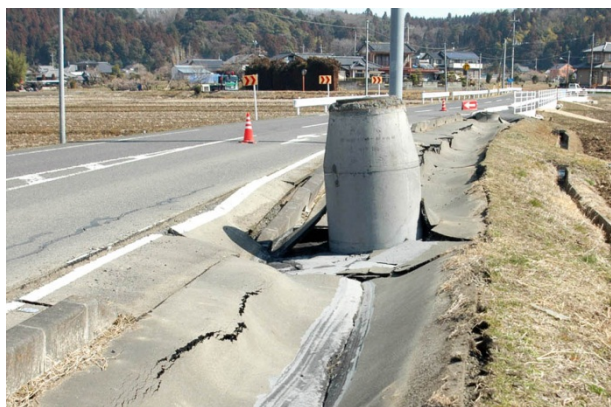
浮き上がったマンホール（常陸太田市）
