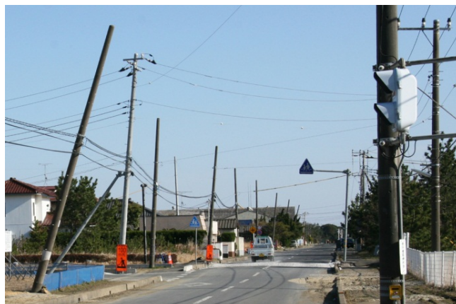
液状化で傾き危険な状態の電柱（神栖市）
