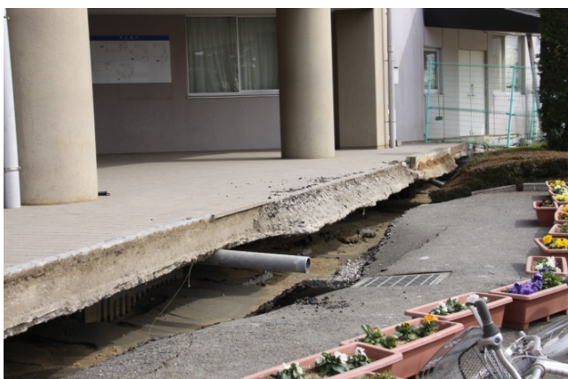
基礎がむき出しとなった日の出中学校（潮来市）
