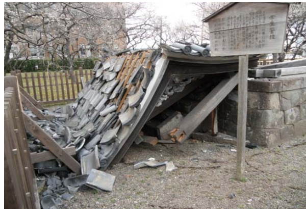
崩れ落ちた弘道館学生警鐘（水戸市）
