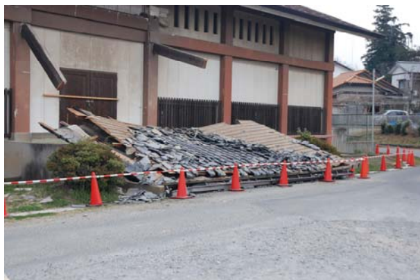
崩落した屋根瓦（常総市）
