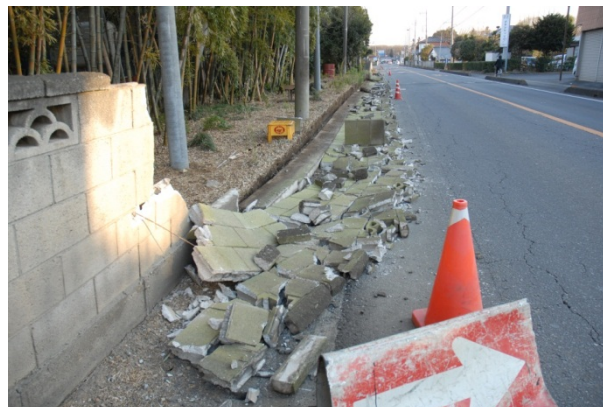
倒壊した住宅地のブロック塀（筑西市）
