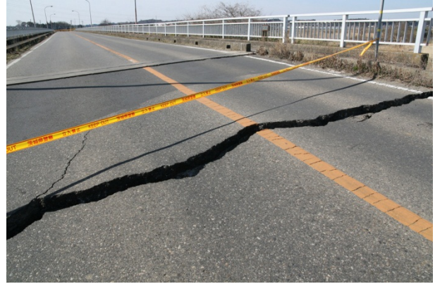
通行止めとなった橋梁（土浦市）
