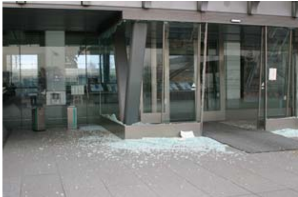
ガラスが破砕した県庁舎行政棟2階正面玄関（水戸市）
