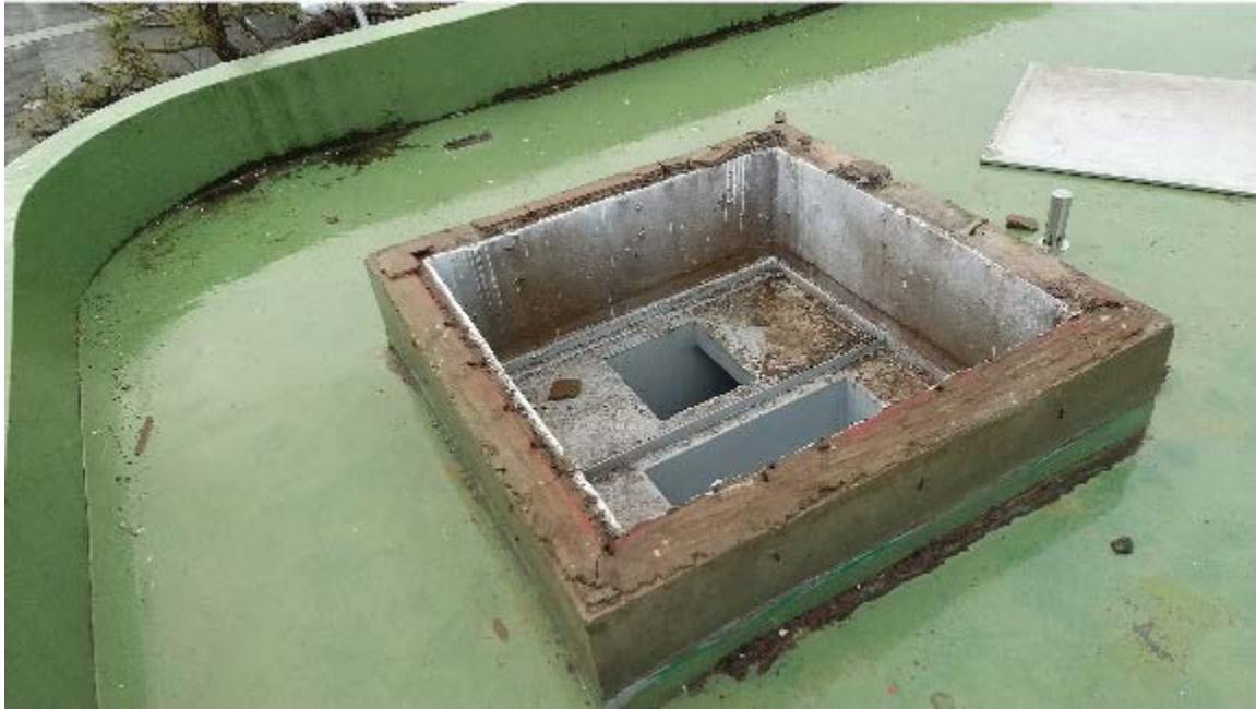
排気筒倒壊直後の開口部(4月13日撮影)
