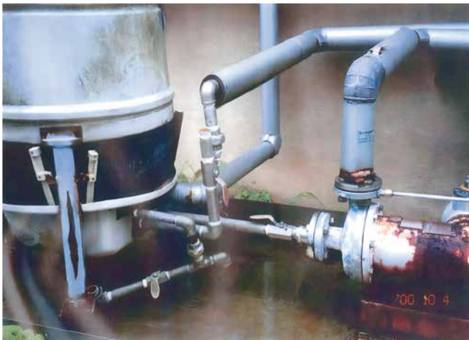
転換試験棟の外に設置されているクーリングタワーの配管 (臨界終息のため、当該配管から沈殿槽冷却水ジャケットの水抜きを実施)
