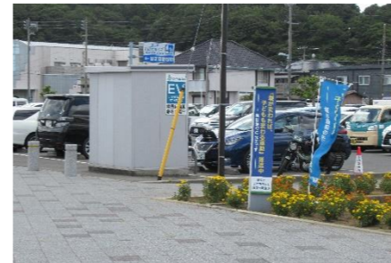
パーキング内の急速EV充電機
