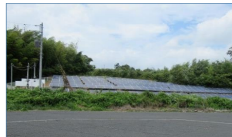
市民運動公園第2駐車場奥の太陽光発電
