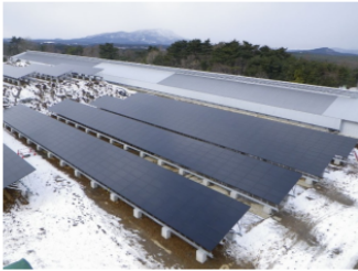
八木農場の太陽光発電設備 (自家利用)
