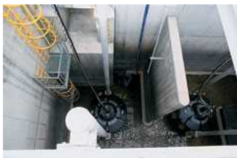
散気施設（桜機場）
